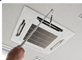
空调出风口测试
